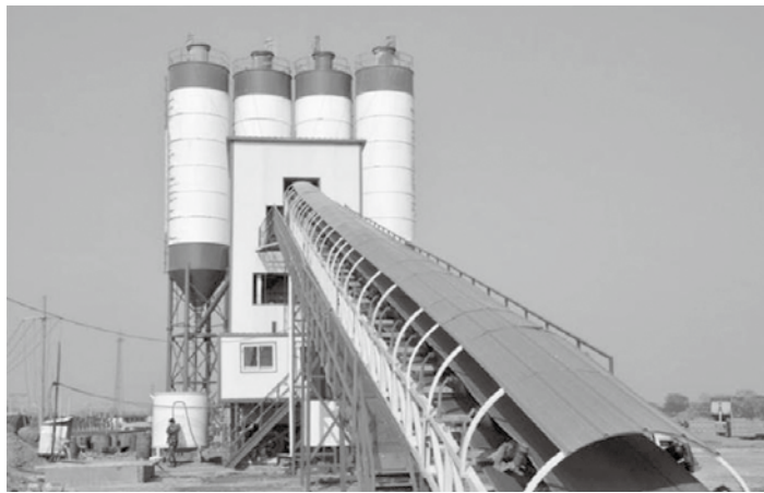
图 1.2.20 混凝土搅拌站
